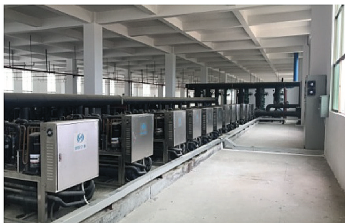
大型环保空调系统
